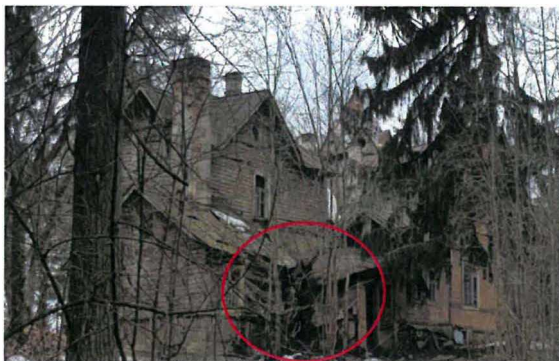
«Дача И. С. Крючкова» (пос. Репино, Приморское ш., 394, корп. 6) Состояние до консервации. Фрагмент 1
