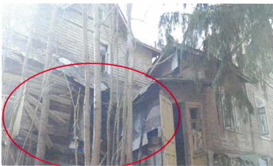
«Дача И. С. Крючкова» (пос. Репино, Приморское ш., 394, корп. 6) Состояние до консервации. Фрагмент 2
