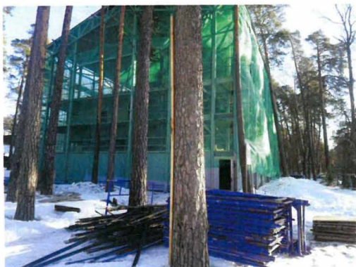
«Загородный дом Л. А. Змигродского» (г. Сестрорецк, Андреева ул., д. 3, лит. А). После выполнения консервационных работ
