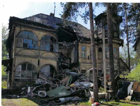
«Дача Н. М. Кочкина» (г. Сестрорецк, М. Горького ул., д. 8, лит. А). Обрушение трапециевидного ризалита в мае 2018
