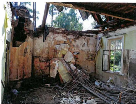
«Дача Н. М. Кочкина» (г. Сестрорецк, М. Горького ул., д. 8, лит. А). Состояние до проведения 1-го этапа консервационных работ. Фрагмент 1
