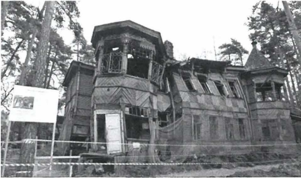
«Загородный дом Л. А. Змигородского» (г. Сестрорецк, Андреева ул., д. 3, лит. А) Состояние 2018 г. до выполнения консервации
