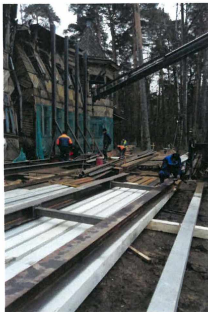
«Загородный дом Л. А. Змигродского» (г. Сестрорецк, Андреева ул., д. 3, лит. А). В процессе выполнения работ по консервации. Фрагмент 3
