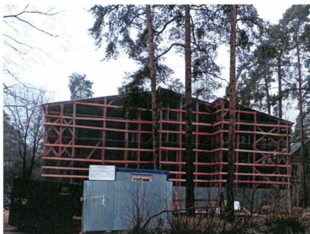
«Дача Н. М. Кочкина» (г. Сестрорецк, М. Горького ул., д. 8, лит. А). После проведения консервационных работ
