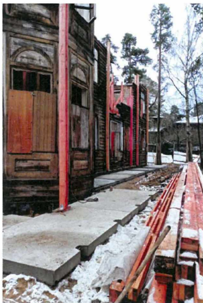
«Дача Н. М. Кочкина» (г. Сестрорецк, М. Горького ул., д. 8, лит. А). В процессе производства работ по консервации. Фрагмент 1
