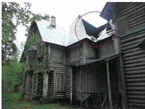
«Дача Е. Ф. Важевской» (г. Сестрорецк, Андреева ул., д. 12, лит. А). Состояние здания до проведения 1-го этапа консервации
