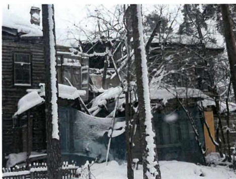
«Дача Н. М. Кочкина» (г. Сестрорецк, М. Горького ул., д. 8, лит. А). Обрушение конструкций в марте 2019 года
