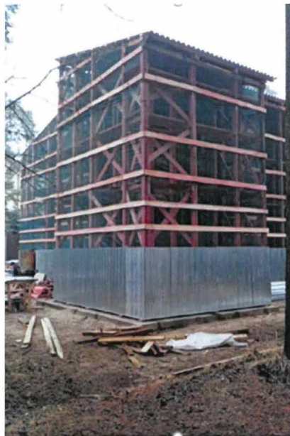
«Дача Н. М. Кочкина» (г. Сестрорецк, М. Горького ул., д. 8, лит. А). Временное защитное сооружение
